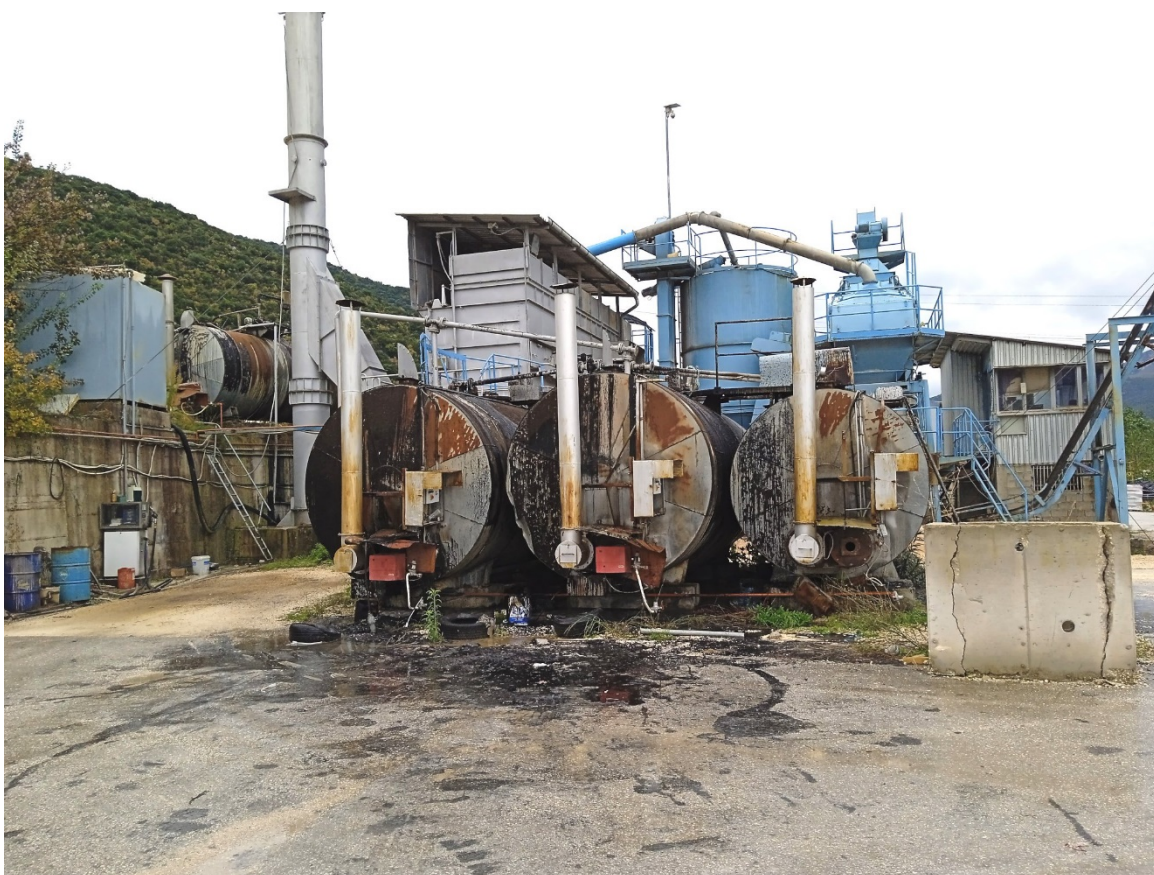
Αποθήκευση – Προθέρμανση Ασφάλτου
