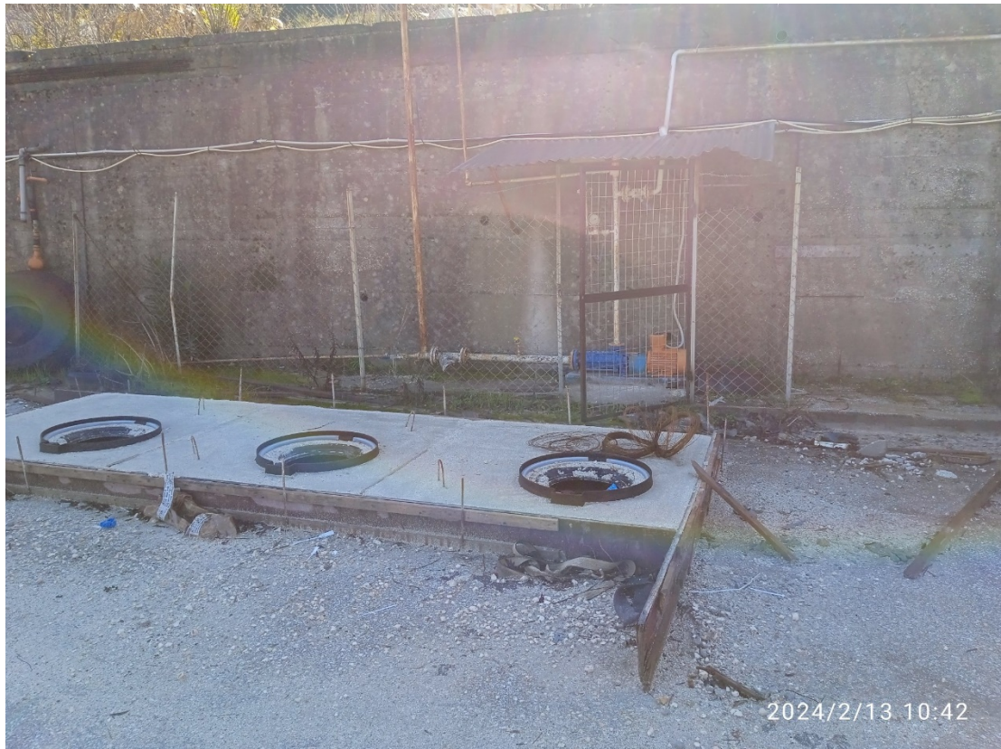
Υπόγεια Δεξαμενή Υγραερίου
